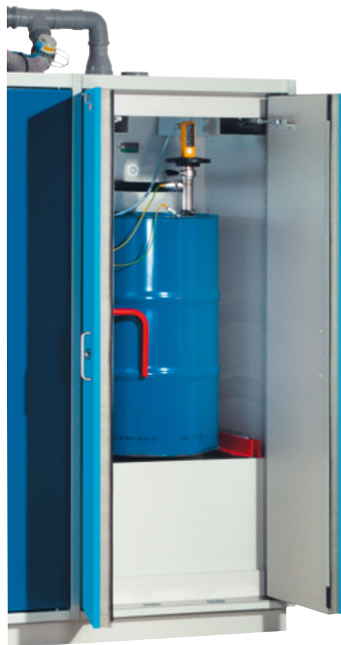
Entnahmestation zur Versorgung des Versuchsaufbaus mit Lösemittel.
